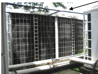
歯科西側本部棟室外機
