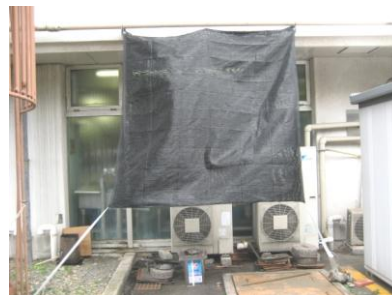
厨房室外機（吊りなわで）
