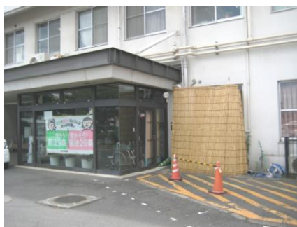
1階玄関横：サーバー室室外機
